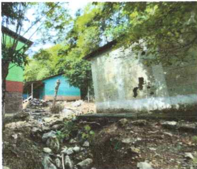
Foto 3: Se observa el mal estado de la parte de atrás de la escuela
