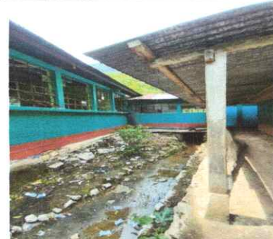
Foto 6: Se observa el mal estado de los ventanales.
