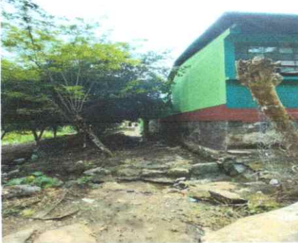
Foto 1: Se observa la entrada al patio trasero y acceso a baños en mal estado
