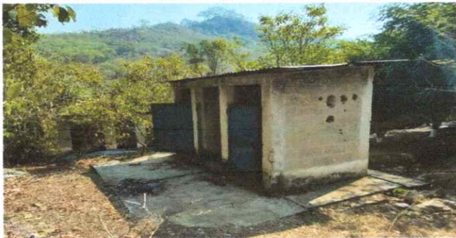
Foto 5: Se observa los baños en mal estado
