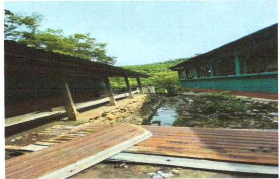
Foto 2: Se observa en mal estado el patio trasero de la escuela.
